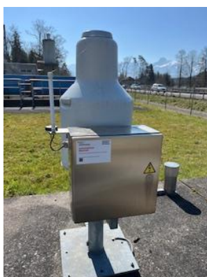
Automatische Messstelle von Meteo Schweiz in der ARA Region Unteres Kiesental
